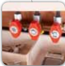
Centrale gasverdeler in de keuken
